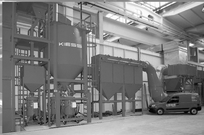
Anlagentechnik einer stationären Großstrahlhalle
